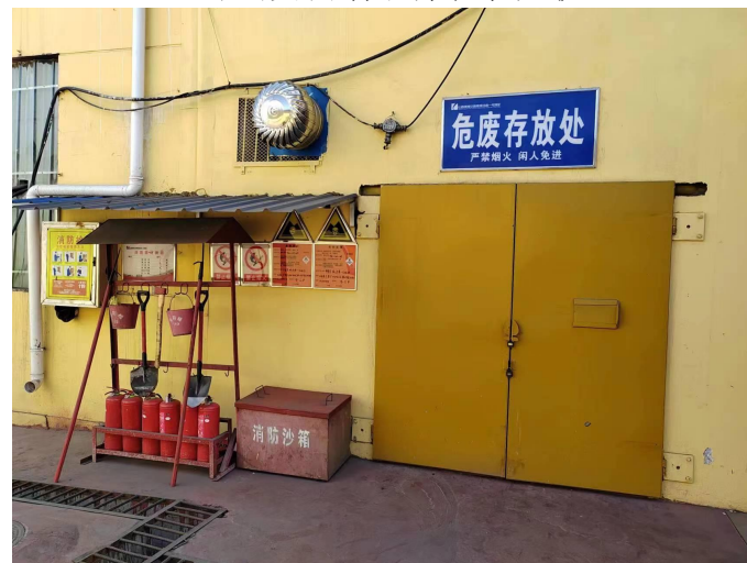
2#危废暂存间大门
