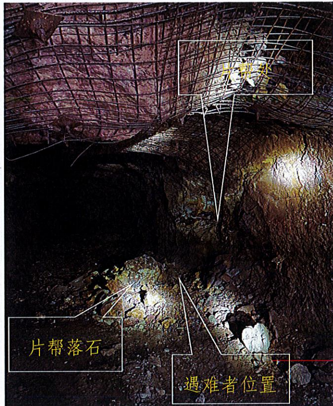
图 2 事故现场照片
